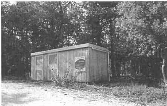
Exemple de locaux techniques s'intégrant dans son environnement en Auvergne-Rhône-Alpes.
